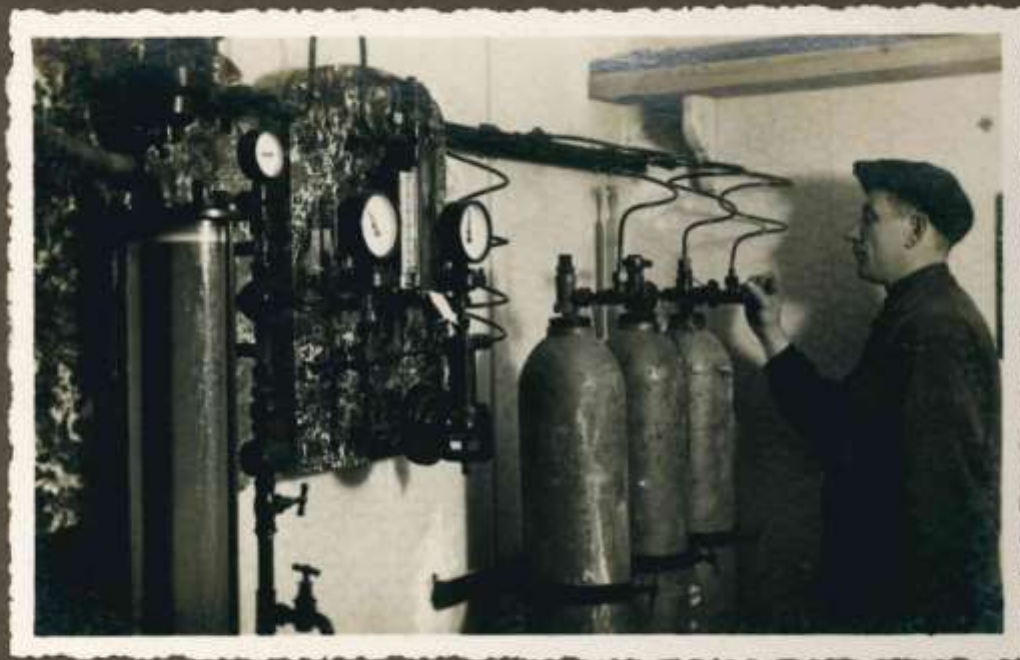
Chlorēšanas ierīce desinficē fabr. vajadzībām lietojamo ūdeni.
